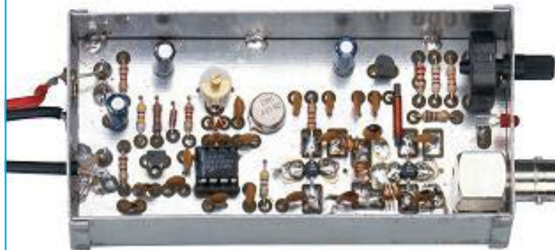
Fig.9 Aspecto de una placa prototipo del Generador instalada dentro de su mueble contenedor metálico.
