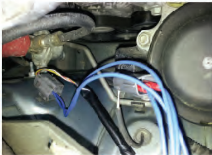
Fig.9 En esta foto se puede ver al enlace entre los dos cables del conector y el aparato.
